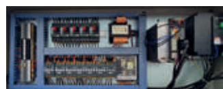
Quadro elettrico con componentistica Schneider
