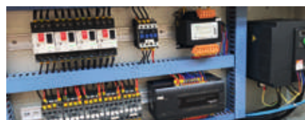
Quadro elettrico con componentistica Schneider
