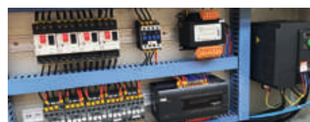
Quadro elettrico con componentistica Schneider
